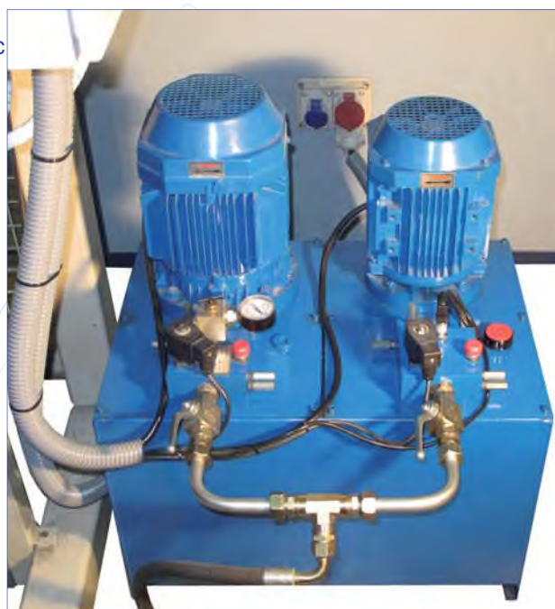
Рис. 17. Гидравлическая силовая установка.
